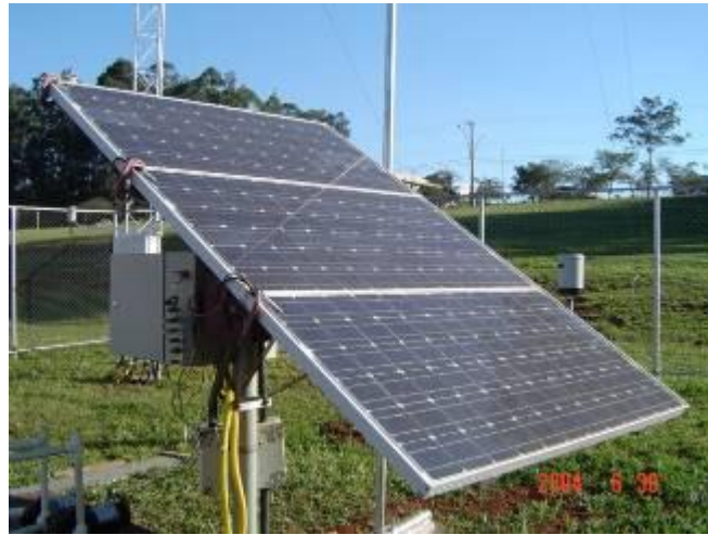
Figura 3. Módulos fotovoltaicos de 100 Wp cada, instalados em paralelo e constituindo o painel fotovoltaico do sistema.
