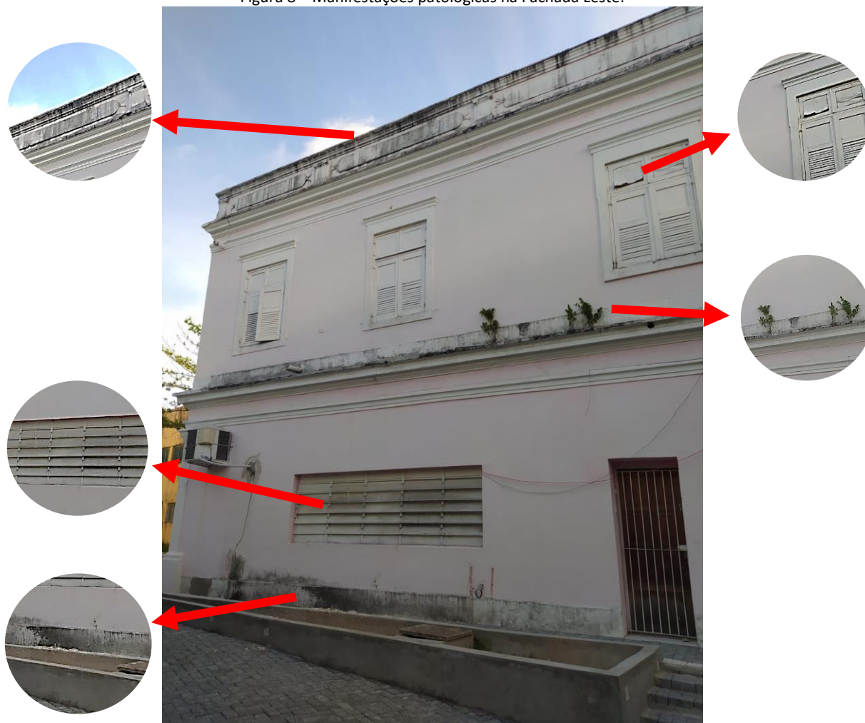
Figura 8 – Manifestações patológicas na Fachada Leste.
