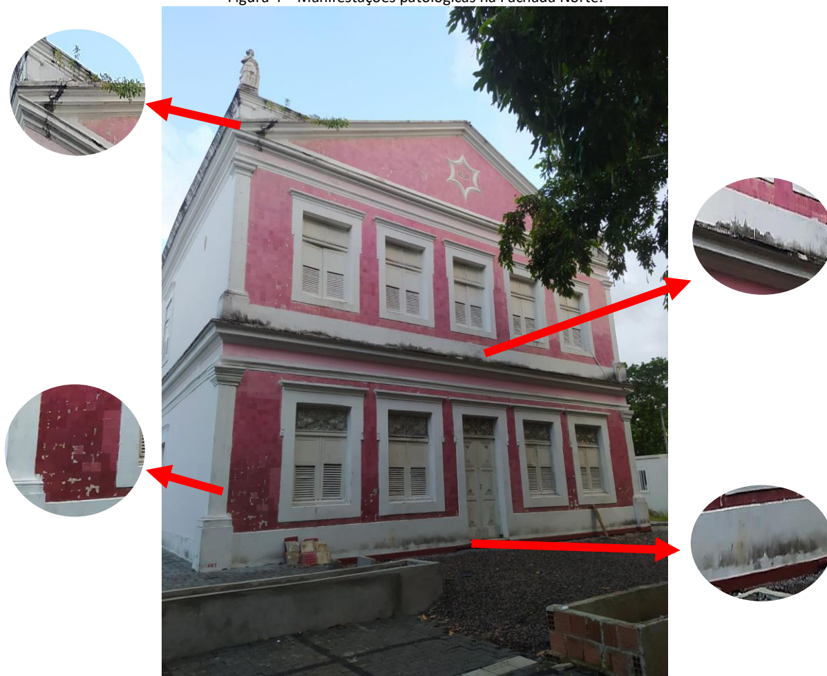
Figura 4 – Manifestações patológicas na Fachada Norte.
