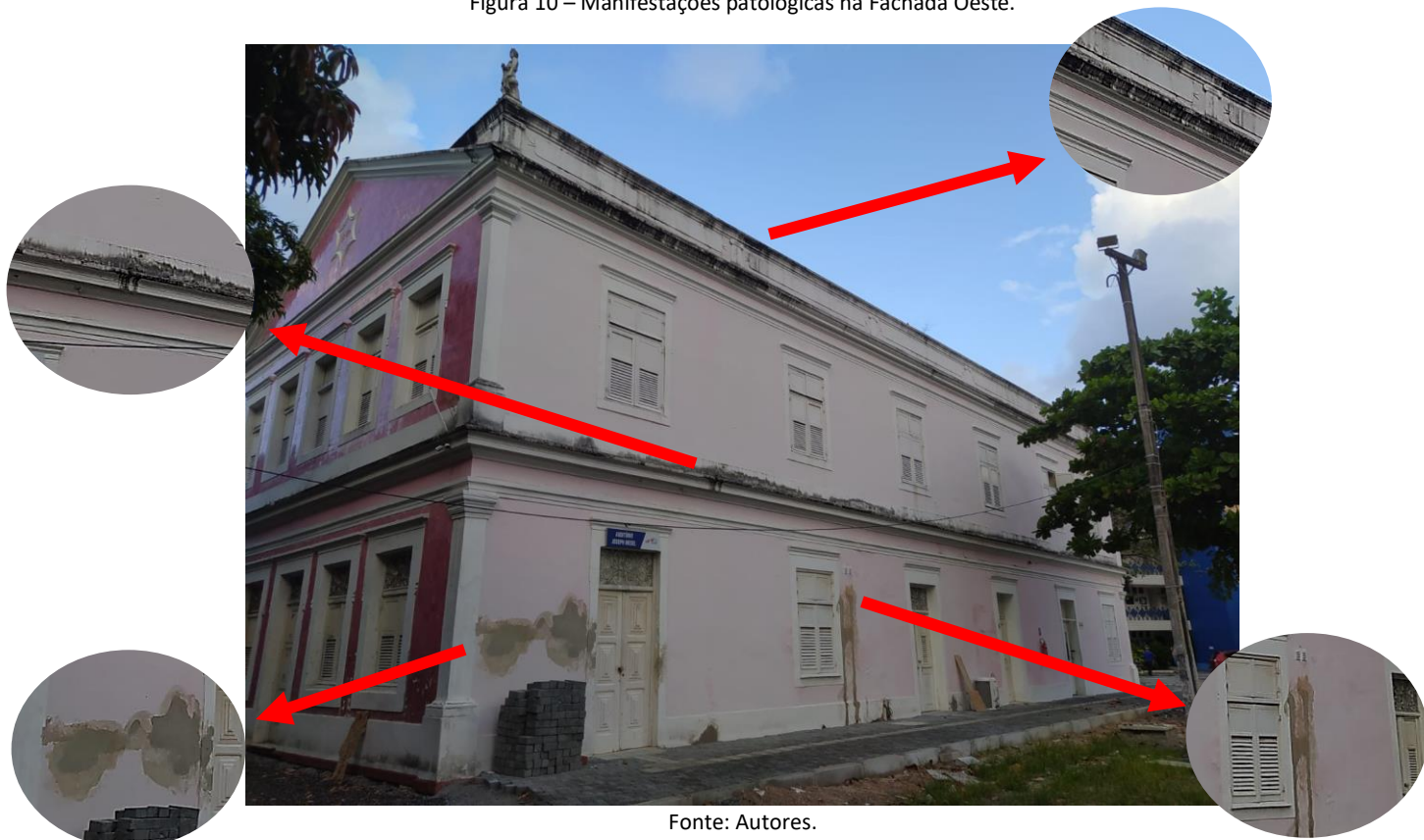
Figura 10 – Manifestações patológicas na Fachada Oeste.
