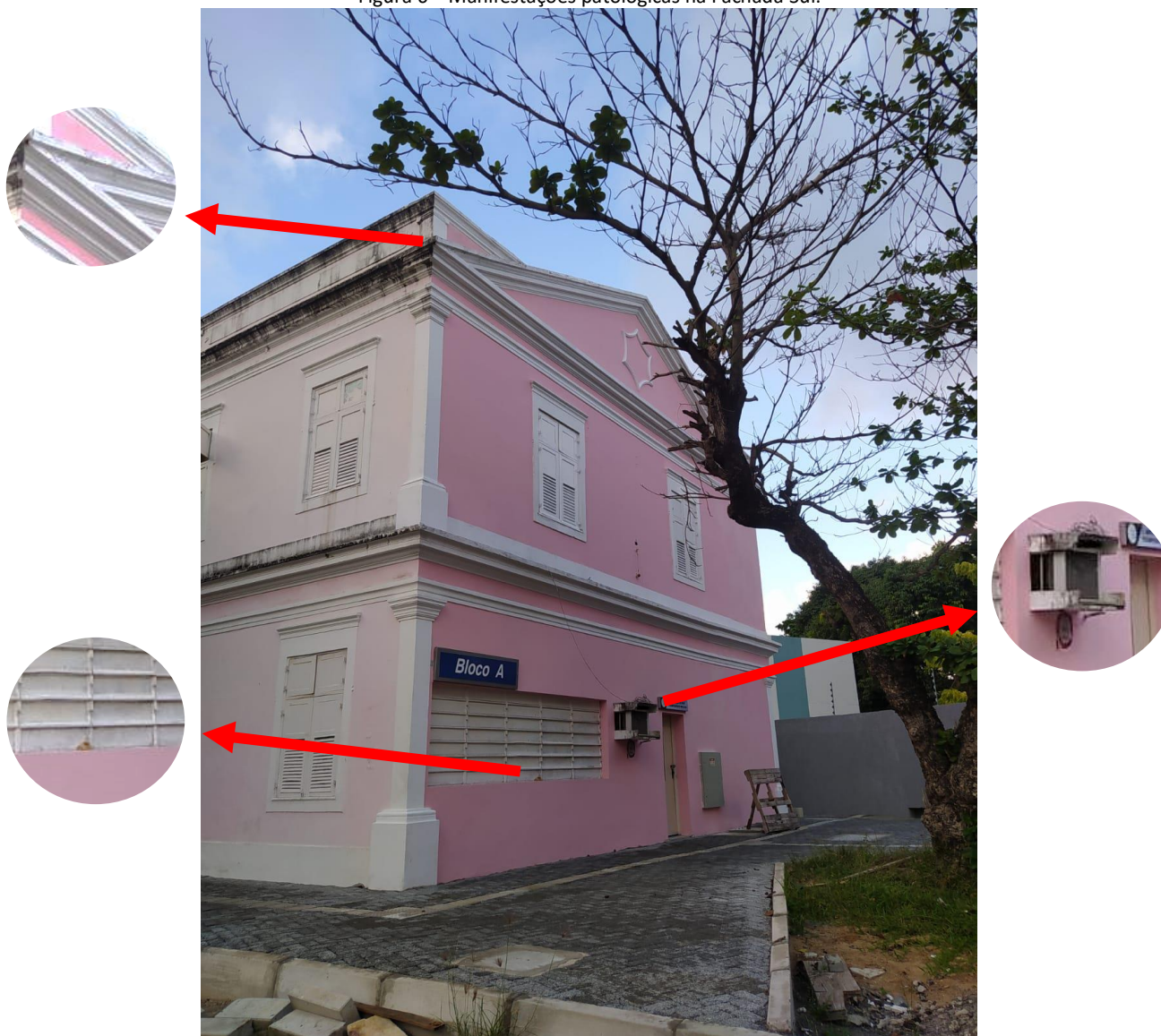
Figura 6 – Manifestações patológicas na Fachada Sul.
