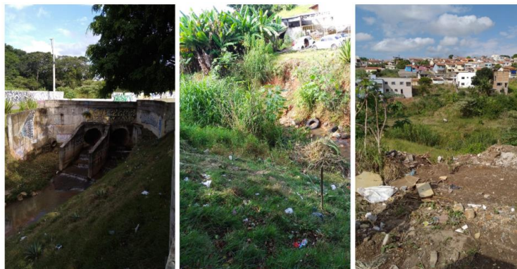
Figura 1 – Lixo em local indevido
