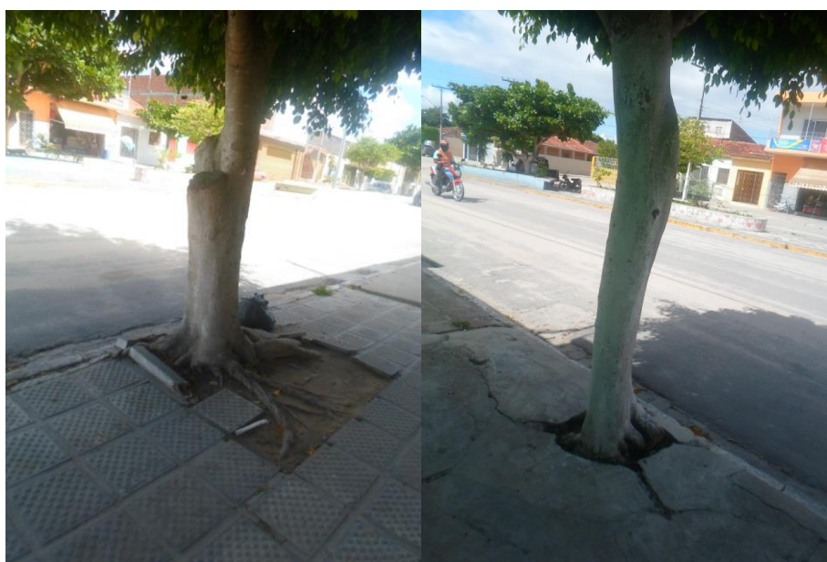
Figura 8. Calçada com Raízes da árvore expostas.
