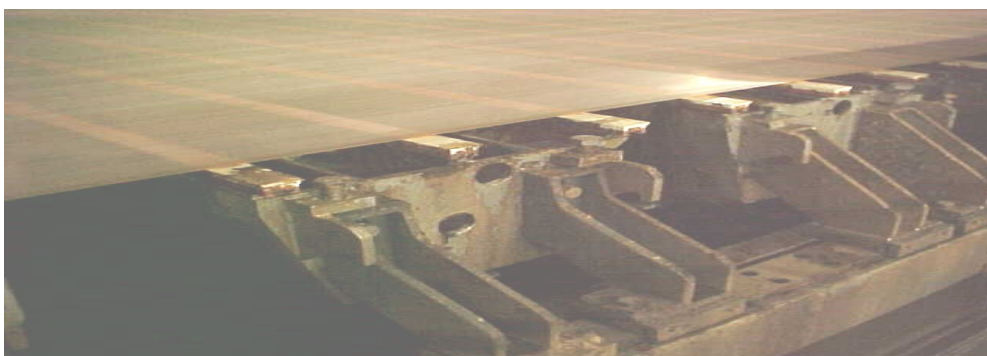
Figura 1 – Caixas de Hidofóils da MP 6, geração de vácuo por gravidade.
