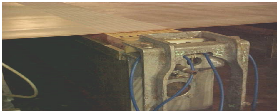
Figura 2 – Caixa de sucção da MP 6, através de bombas de vácuo.
