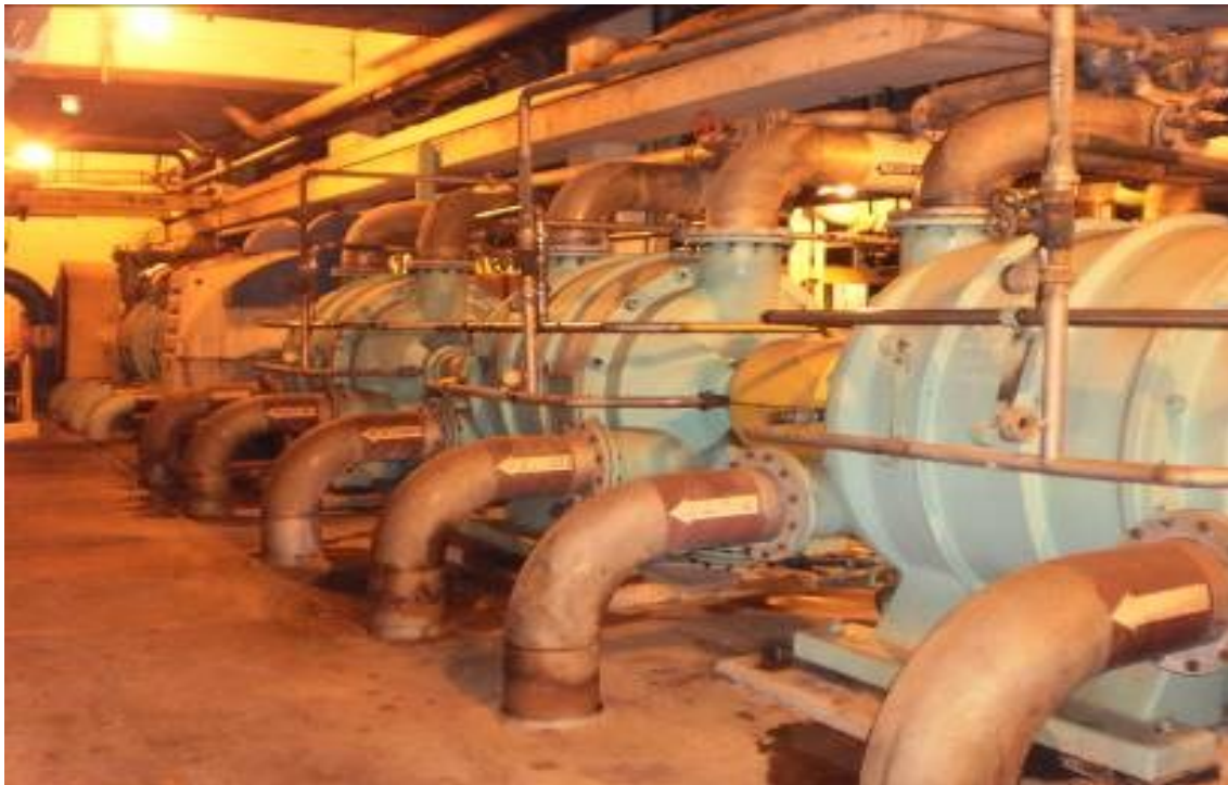
Figura 5 – Bombas de vácuo da MP 6.
