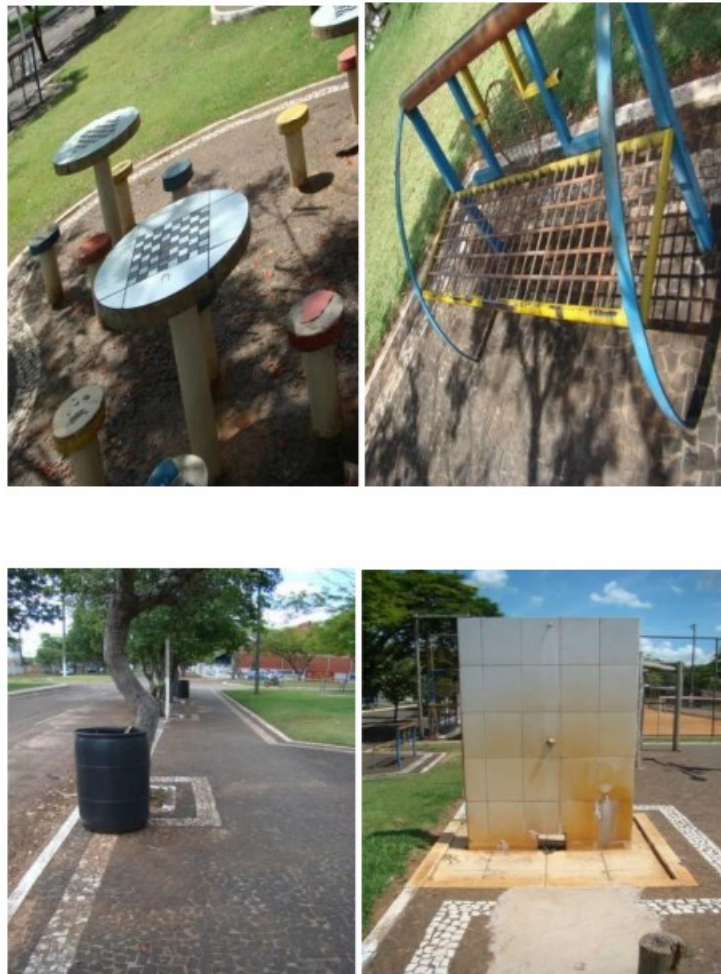
Figura 01: Imagens da praça que demonstram a existência de lixeiras, bancos, mesas de xadrez e chuveiro para saída da quadra de areia, porém, totalmente sem qualquer manutenção.
