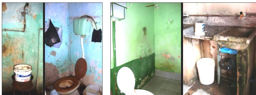
Figuras 09 e 10: Imóveis ilustrando a precariedade das instalações elétricas e hidráulicas encontrada em grande parte das edificações visitadas.
