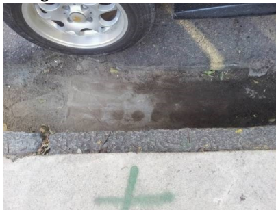
Figura 8: Boca de lobo obstruída.
