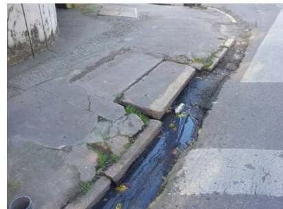
Figura 13: Presença de esgoto na rede de drenagem.
