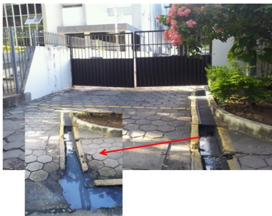
Figura 12: Ligação direta da drenagem do prédio na rua.
