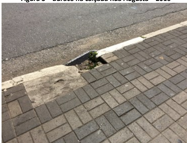
Figura 3 – Buraco na calçada Rua Augusta – 2016
