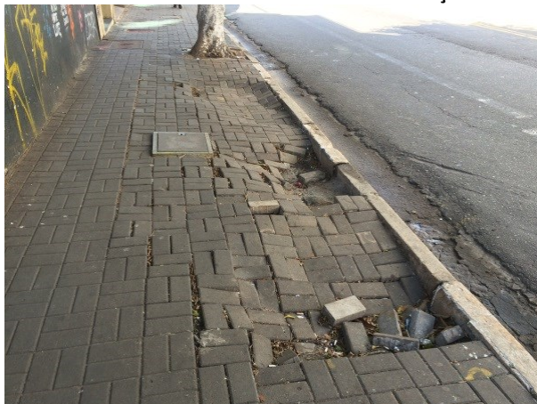
Figura 2 – Intertravado de Concreto solto ou defeituoso na calçada Rua Augusta – 2016
