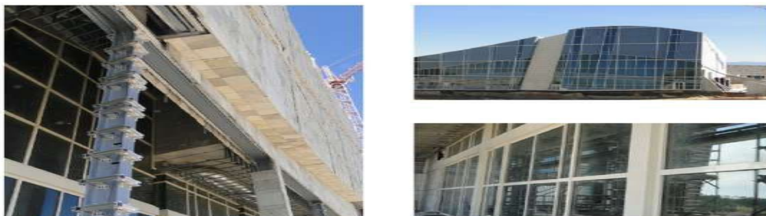
Figura 5: Detalhe do sistema construtivo da obra, estrutura metálica, fechamento em vidro e fachada revestida da pedra galícia- elemento natural do lugar
