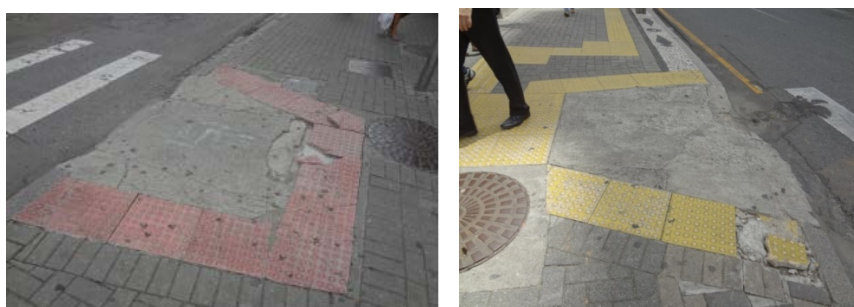
Figura 07 – Guias rebaixasadas com sinalização visual e tátil desgastadas
