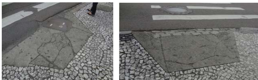
Figura 06 – Guias rebaixasadas sem sinalização e com ondulações, fissuras e peças soltas
