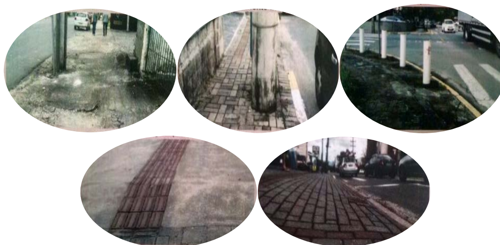
Figura 3 - Revestimento irregular, obstrução do passeio, cruzamento com obstáculos, inclinação e desnível desconforme
