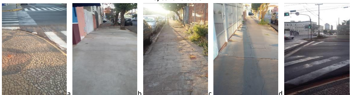
Figura 6: Problemas relacionados ao Tema Conforto - a) sinalização; b) arborização; c) atratividade; d) inclinação; e) continuidade
