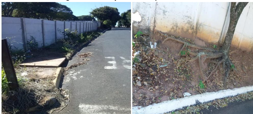
Figura 9: Falta de calçada na rua Joaquim Abreu Luz.
