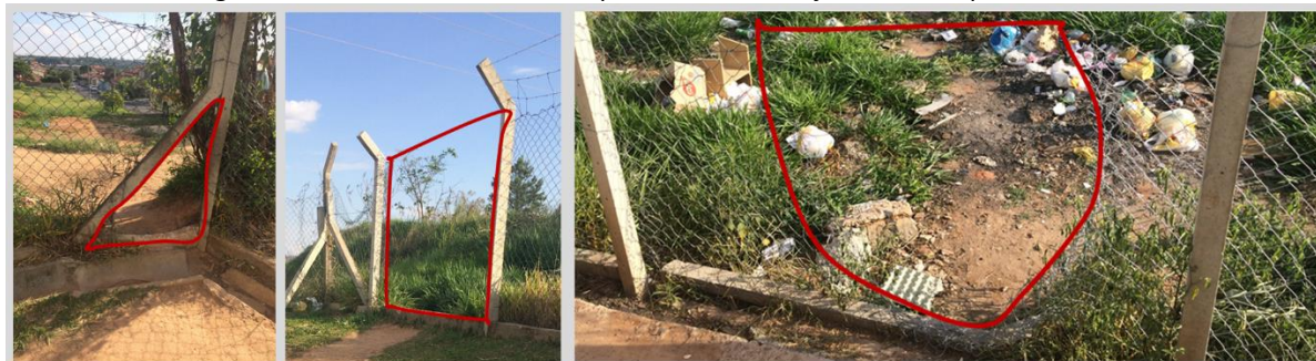
Imagem 7 - Falhas nos alambrados que cercam os conjuntos feitas pelos moradores
