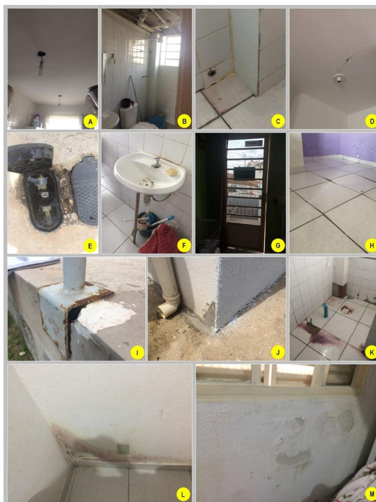
Imagem 8 - Problemas construtivos encontrados nas unidades habitacionais
