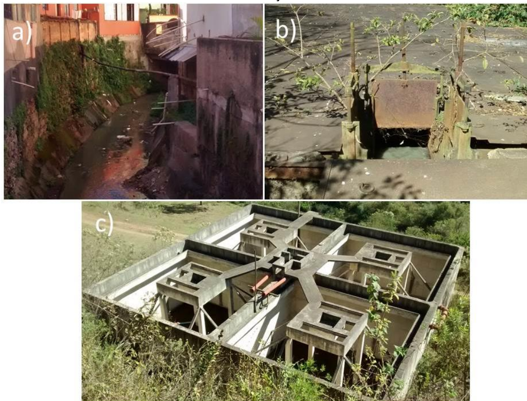
Figura 1: a) Esgoto lançado diretamente em corpo d'água; b) Primeira ETE de Minas Gerais; c) Construção da ETE Osso de Boi em situação de abandono
