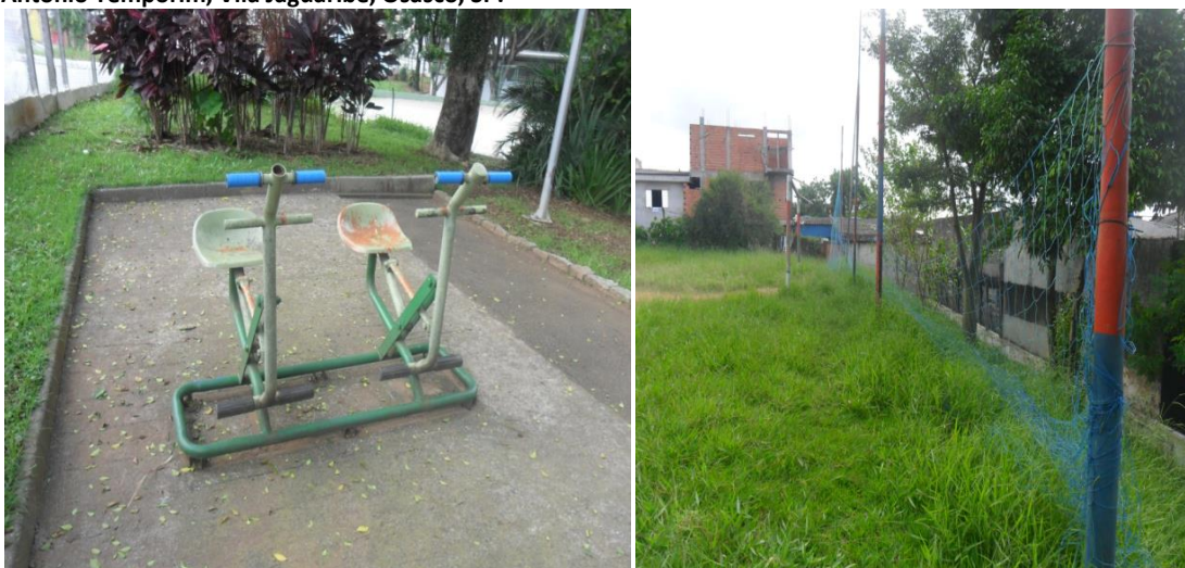
Figuras 7A e 7B. Aparelho de ginástica enferrujado e rede esportiva de contenção danificada no Parque de Lazer Antônio Temporim, Vila Jaguaribe, Osasco, SP.
