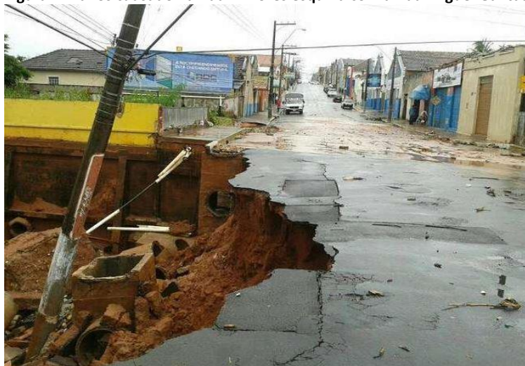
Figura 1: Danos causado na Rua Aimorés esquina com a Rua Miguel Gantus.
