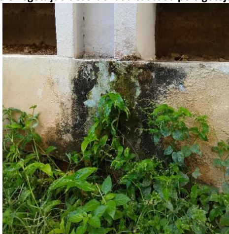
Figura 1: Manchas de infiltração e vegetação desordenada causada pelo gotejamento de água de condensação
