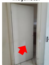
Figura 10: Portas dos banheiros femininos (Setor 5) sem maçaneta.
