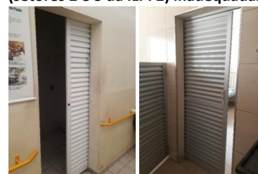
Figura 11: Portas de acesso aos banheiros (setores 2 e 3 da ILPI 2) inadequadas.
