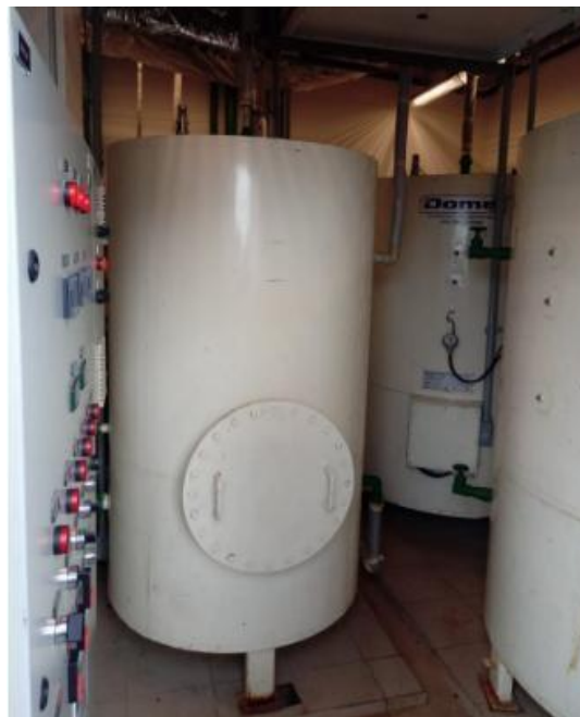
Figura 9 – Boilers do sistema de aquecimento do SESC Paulista.
