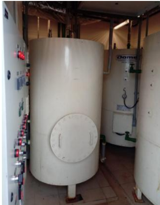
Figura 9 – Boilers do sistema de aquecimento do SESC Paulista.
