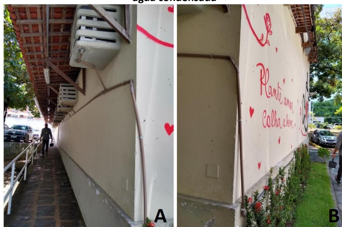
Figura 1: (A) Sistema de coleta da água condensada da edificação térrea anexa; (B) Área ajardinada irrigada pela água condensada
