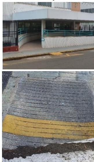
Figura 9: Alguns problemas relacionados ao tema Rebaixo de calçada – RC 01 e 04.
