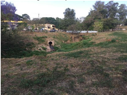
Ponto 4 – Escorregamento de terra e foco de poluição no córrego vistos de jusante à montante
