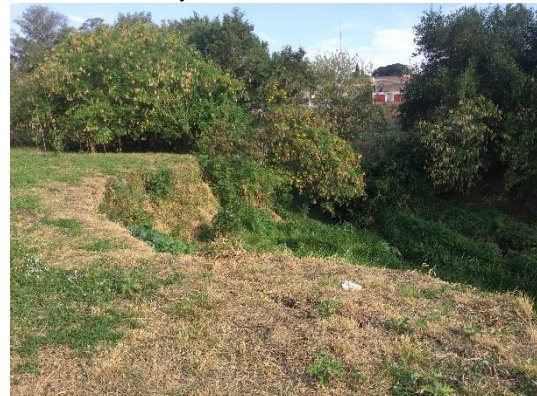
Ponto 5 – Escorregamento de terra no córrego visto de jusante à montante
