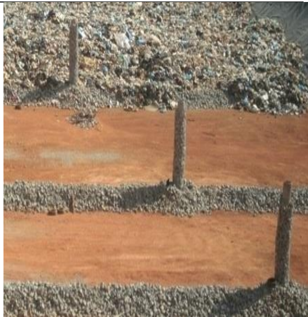
Figura 1.4 - sistema de drenagem de gases da célula em operação
