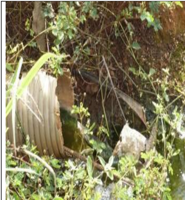
Figura 1.3 - (vistoria NATURATINS/ 2012): Drenos danificados
