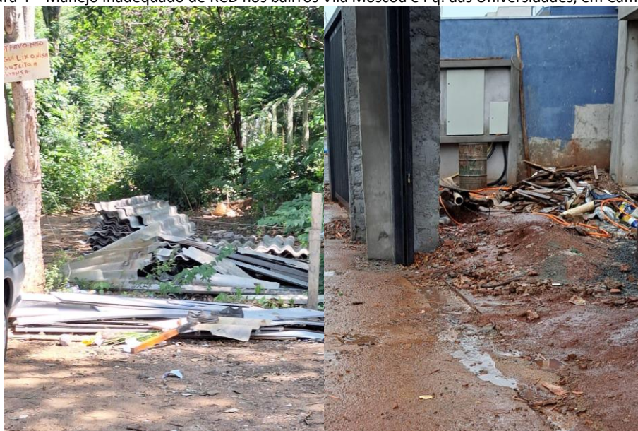
Figura 4 – Manejo inadequado de RCD nos bairros Vila Moscou e Pq. das Universidades, em Campinas
