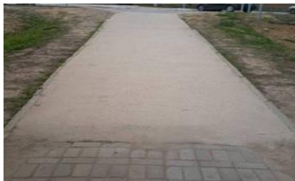
Figura2: Rampa sem corrimão, guarda corpo, piso tátil e piso direcional.
