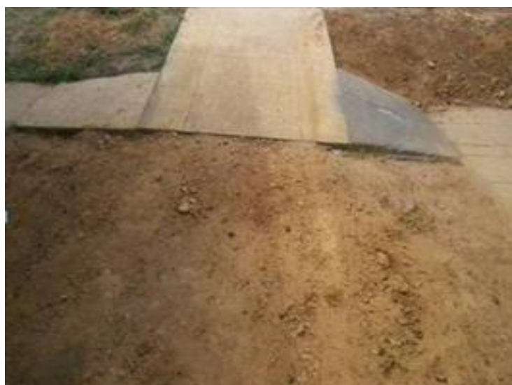
Figura3: Rampa sem finalização e fora do ângulo de inclinação.
