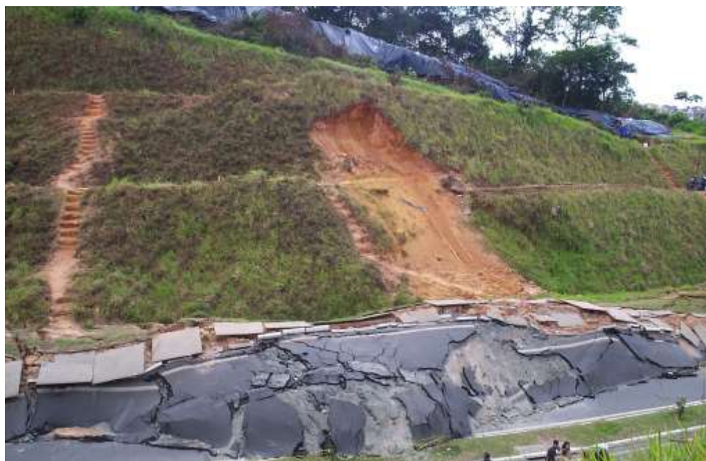
Figura 1: Escorregamento de solo em Salvador-BA
