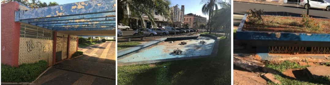
Figura 6, 7, 8: Azulejos, onde se vê a área comercial, fonte e cobogó. Todos em precário estado de conservação.
