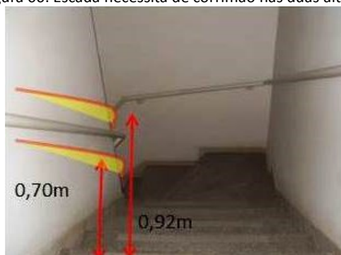
Figura 06: Escada necessita de corrimão nas duas alturas.
