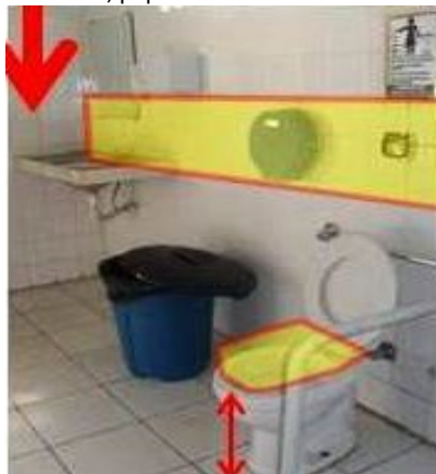
Figura 05: Sanitário acessível com bacia baixa, papelreira acima da faixa de alcance e lavatório sem barra de apoio.
