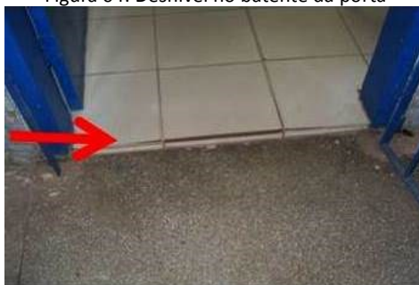
Figura 04: Desnível no batente da porta
