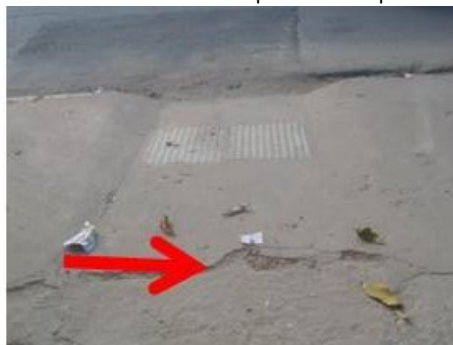
Figura 03 - Rebaixo do meio fio em frente ao prédio e em piso danificado na calçada.
