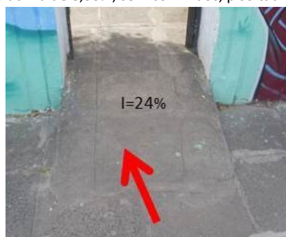
Figura 02: Rampa com inclinação acima de 8,33%, sem corrimãos, piso tátil e ocupa parte da calçada externa.
