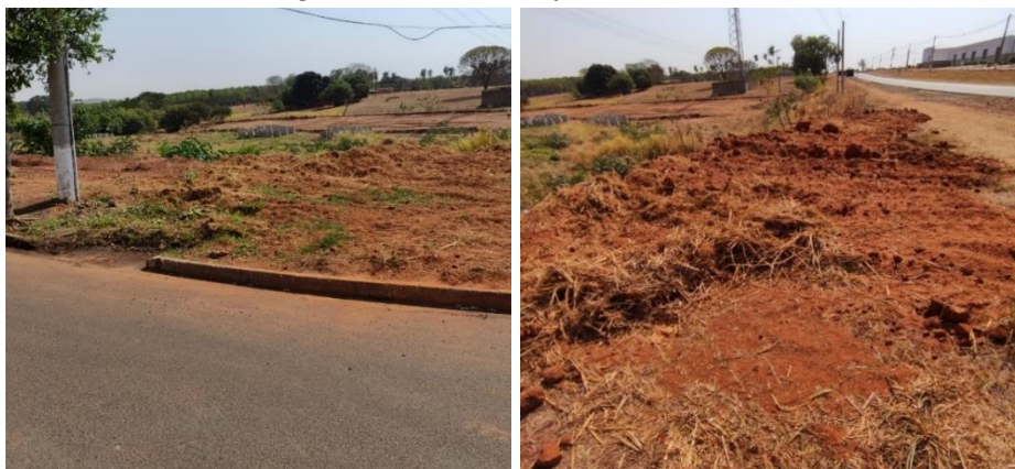
Figura 8: Estado atual do ponto de erosão A
