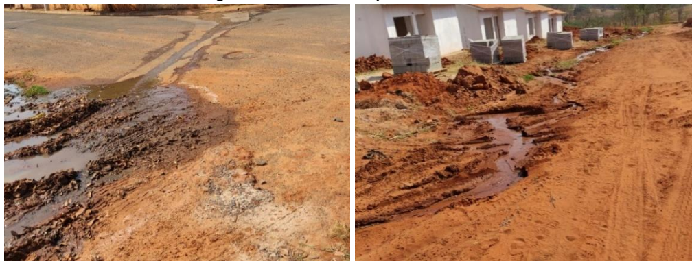
Figura 9: Estado atual do ponto de erosão B
