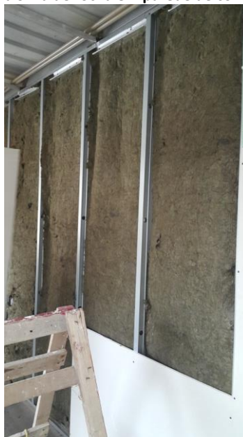
Figura 9: Lã de rocha em parede de contêiner
