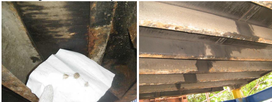
Figura 8: Parte inferior do piso do contêiner com revestimento de tinta
