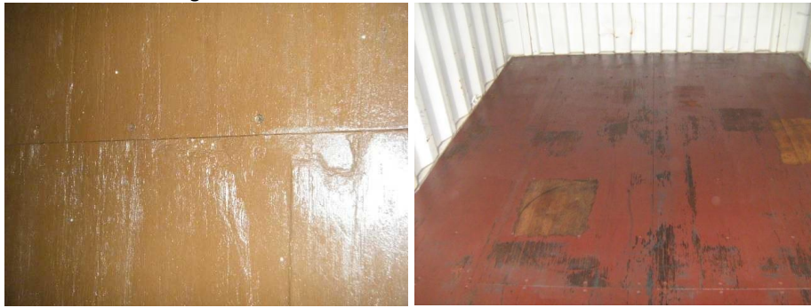
Figura 7: Piso do contêiner com revestimento de tinta
