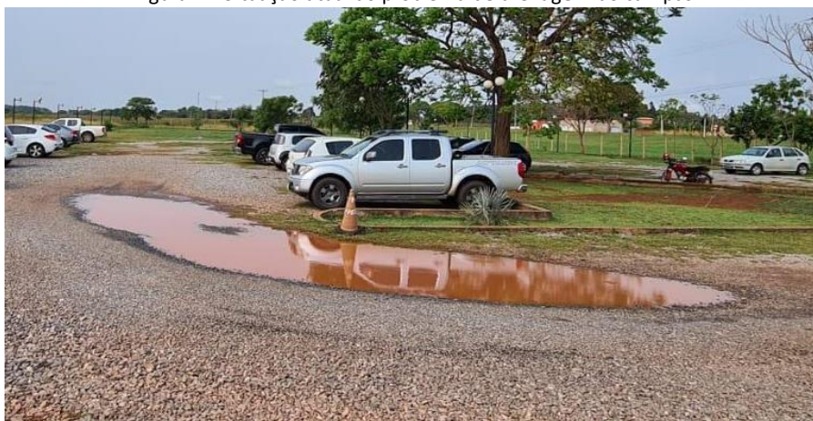
Figura 4 – Situação atual do problema de drenagem do campus
