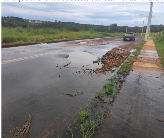
Imagem 2: Uberaba-MG: Condição da avenida de acesso aos loteamentos Parque dos Girassóis III e IV – 2023
