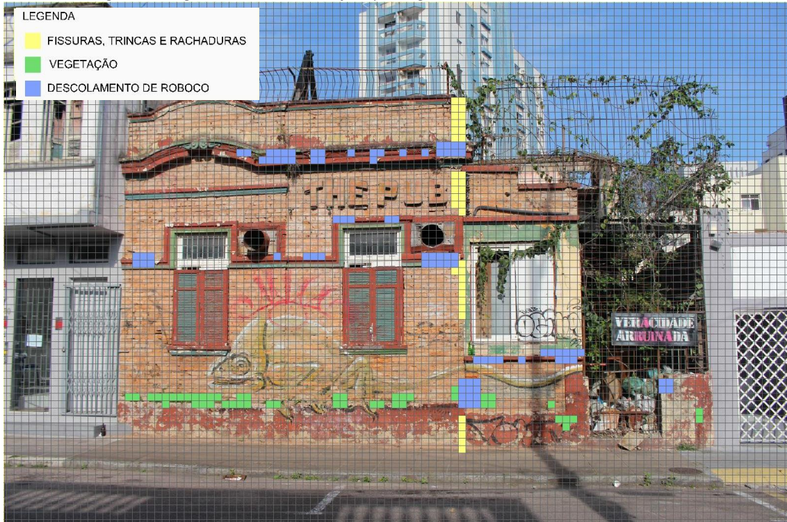
Figura 3 - Diagnóstico das manifestações patológicas da residência na Rua Anita Garibaldi.
