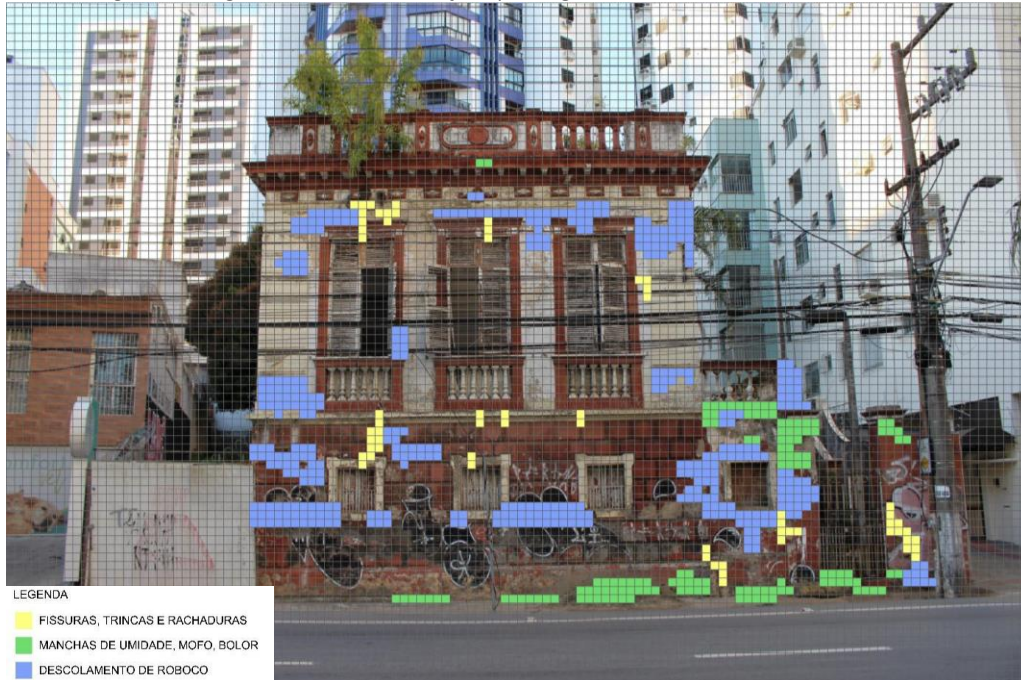
Figura 7 - Diagnóstico das manifestações patológicas da residência na Rua Rui Barbosa.
