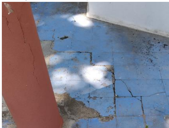
Figura 11 – Fendas no piso externo – térreo
