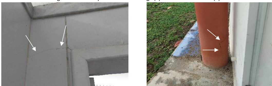
Figura 9 – Fissura por ausência de verga (a) e trinca de corrosão (b)
