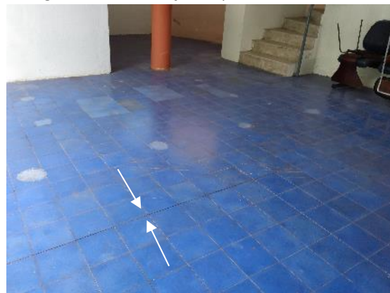
Figura 12 – Deformação do piso interno – térreo
