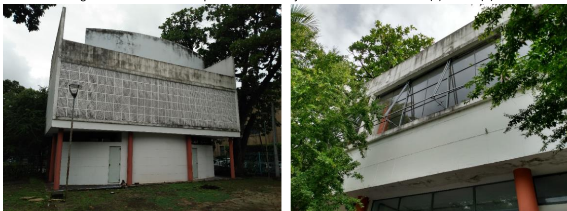
Figura 6 – Manchamentos por acúmulo de sujidades nas fachadas oeste (a) e leste (b)
