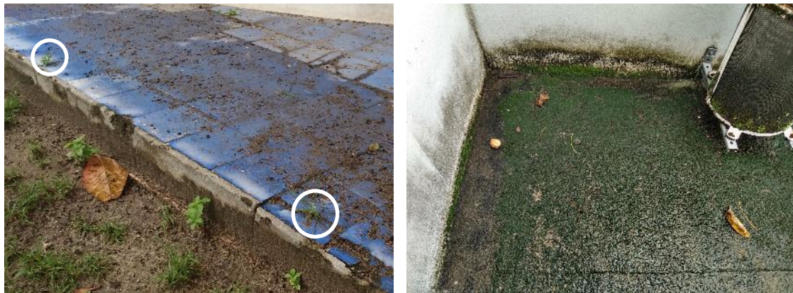
Figura 14 - Infestação vegetal entre ladrilhos do pavimento térreo (a) e no teto-terraço (b)
