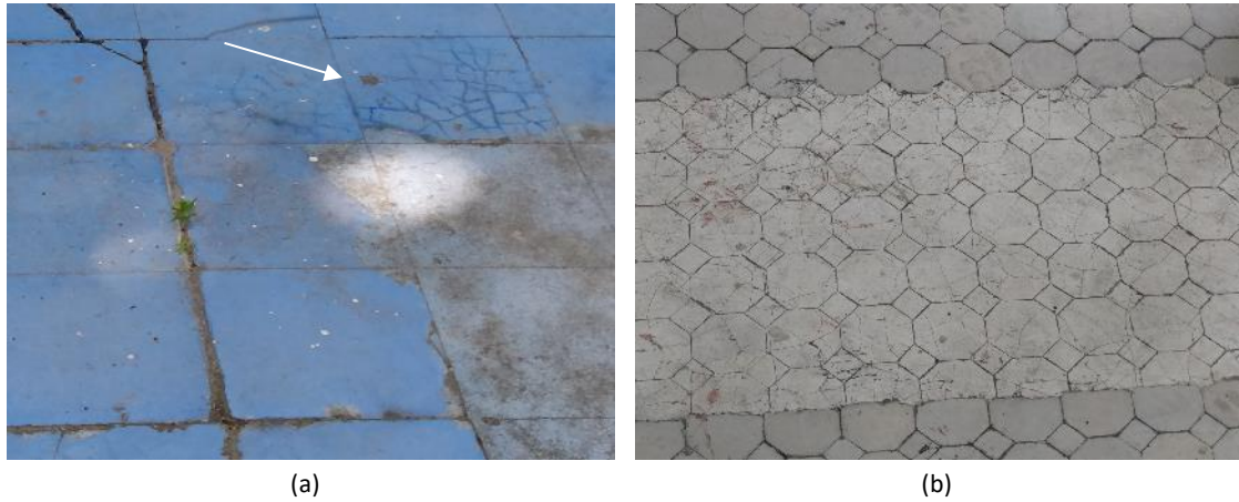
Figura 10 - Fissuras superficiais no ladrilho hidráulico da área externa do térreo (a) e de sala do 1º pavimento (b)
