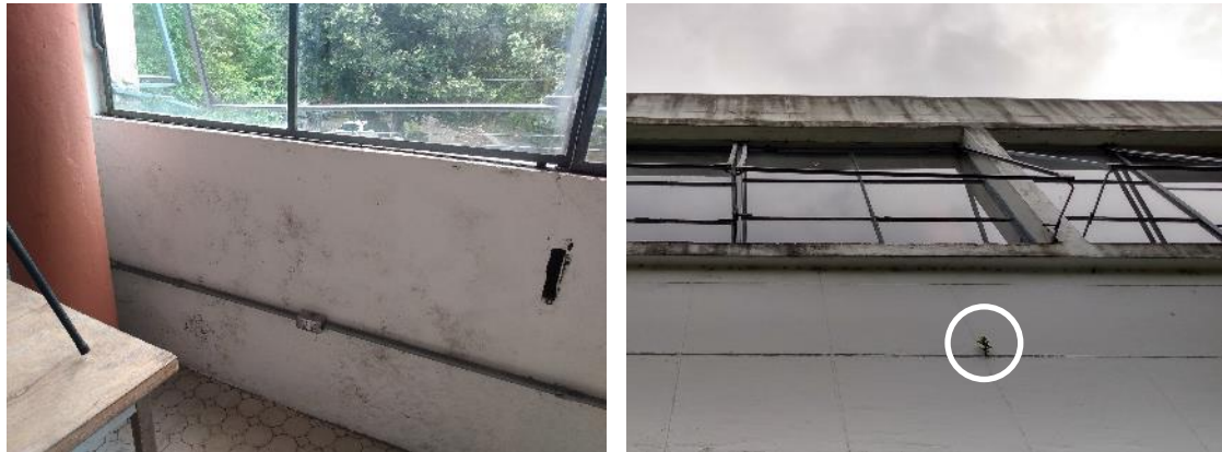
Figura 13 – Infestação biológica em parede sob esquadria (a) e infestação vegetal (b) – fachada leste
