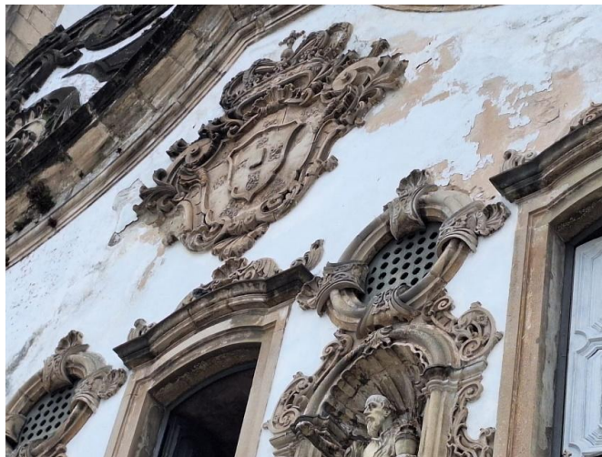
Figura 8 – Destacamento do revestimento Basílica de Nossa Senhora do Carmo, Recife/PE.
