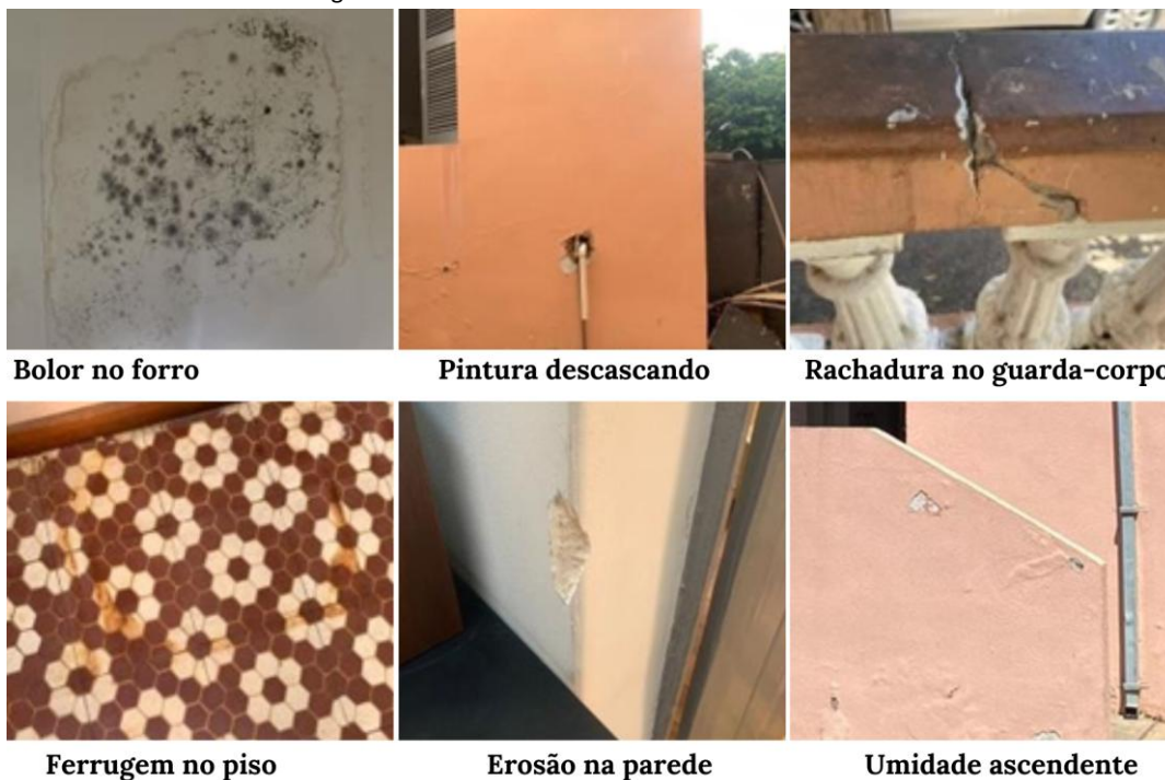
Figura 7 – Danos visíveis na Casa da Dona Carlotinha
