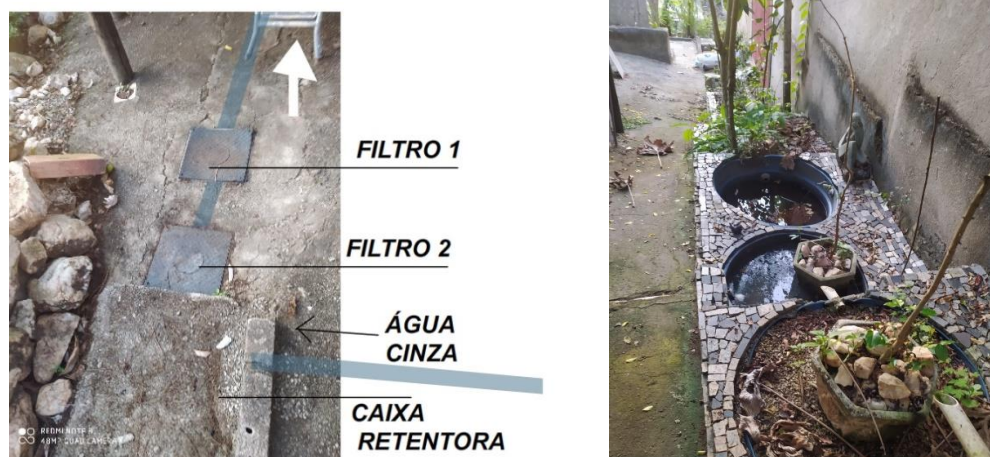
Figura 2 – Sistema construído para águas cinzas.
