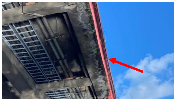
Figura 6: Presença de Bolor na parte inferior da Ponte Princesa Isabel.
