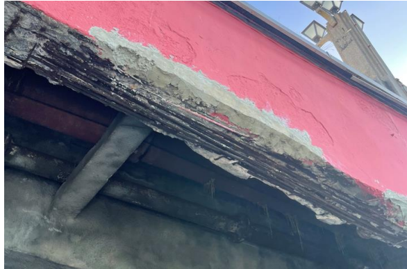
Figura 7: Situação de armadura localizada na parte de baixo da ponte Santa Isabel.
