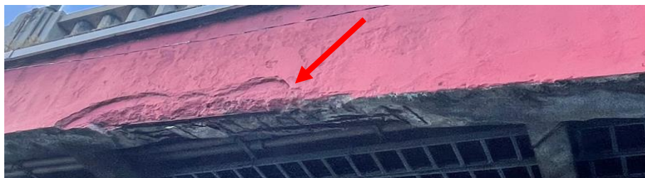
Figura 9: Desagregação de material presente na fachada da Ponte Santa Isabel, 2022.
