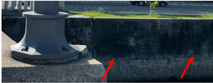
Figura 16: Manchas de umidade na lateral da ponte Princesa Isabel.
