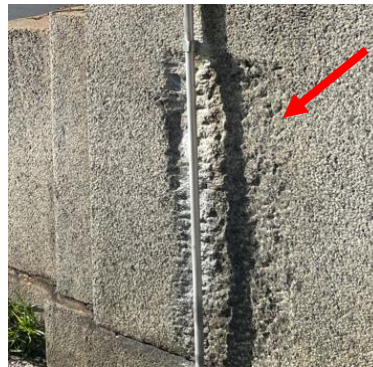
Figura 11: Perda de massa observada no corpo do poste na ponte Santa Isabel.
